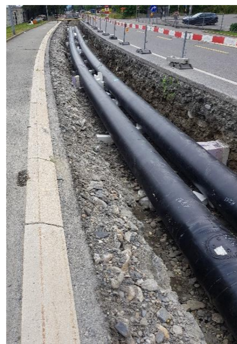
Conduites de chauffage à distance
