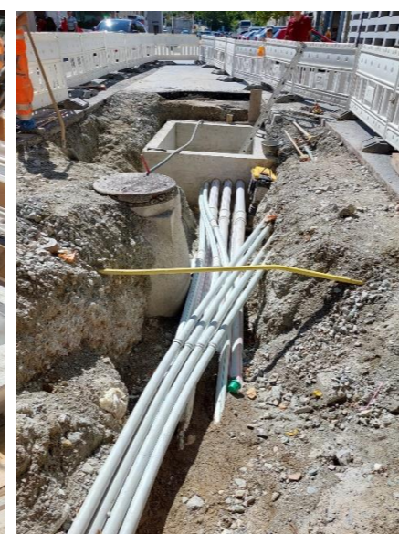
Canalisations électriques et gaz
