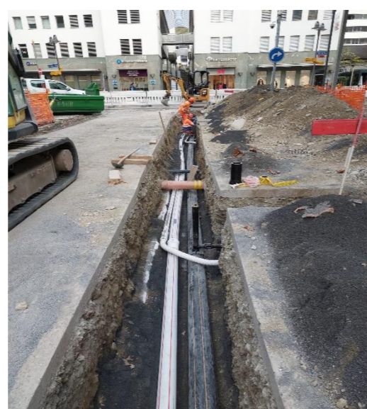
Canalisations électriques et gaz
