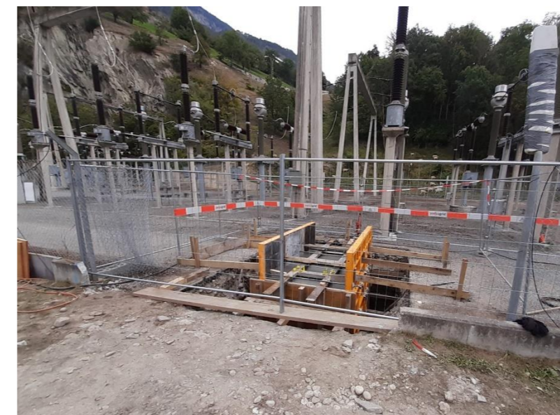
Travaux à proximité de parties en tension
