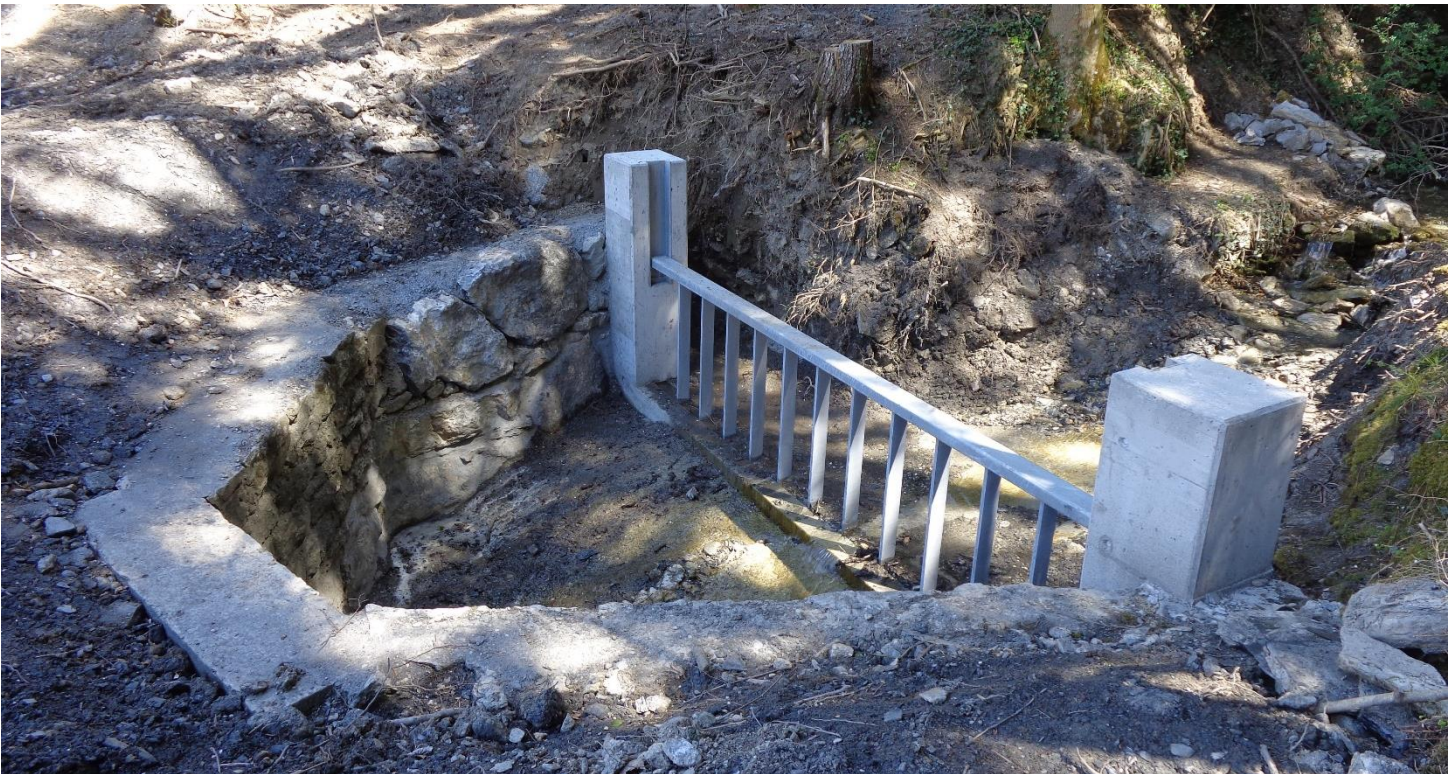
Ouvrage d'accès avec grille métallique UNP
